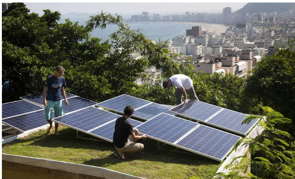
Figura 2 - Painéis fotovoltaicos. Fonte: Imbuzeiro (2009).
