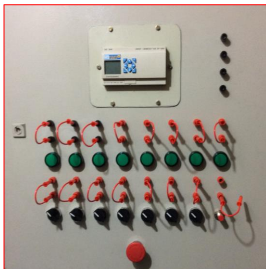
Figura 16 – Painel com CLP WEG Clic02. Fonte: autores.
