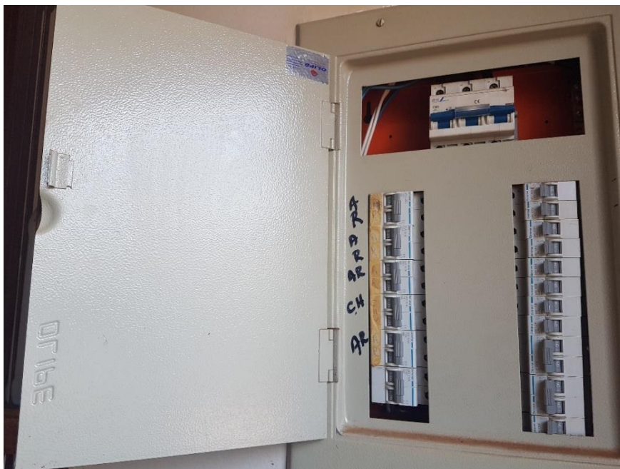
Figura 3 - Quadro de distribuição. Fonte: autores.
