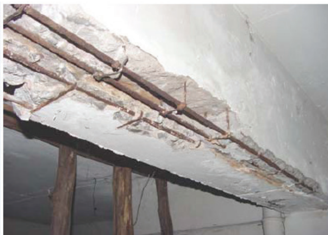
Figura I: Danos em viga de edifício residencial (FERRARI, 2007).
