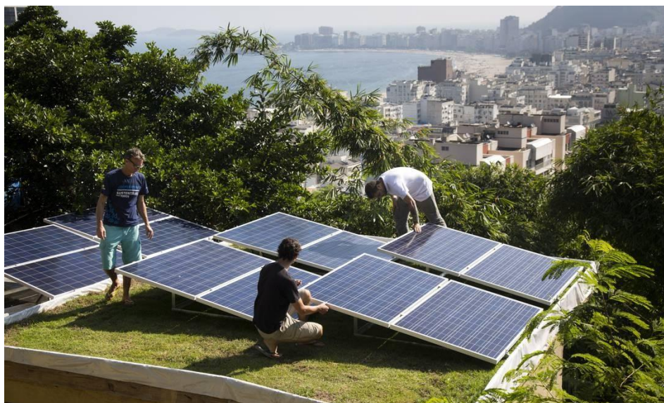
Figura 2 - Painéis fotovoltaicos. Fonte: Imbuzeiro (2009).
