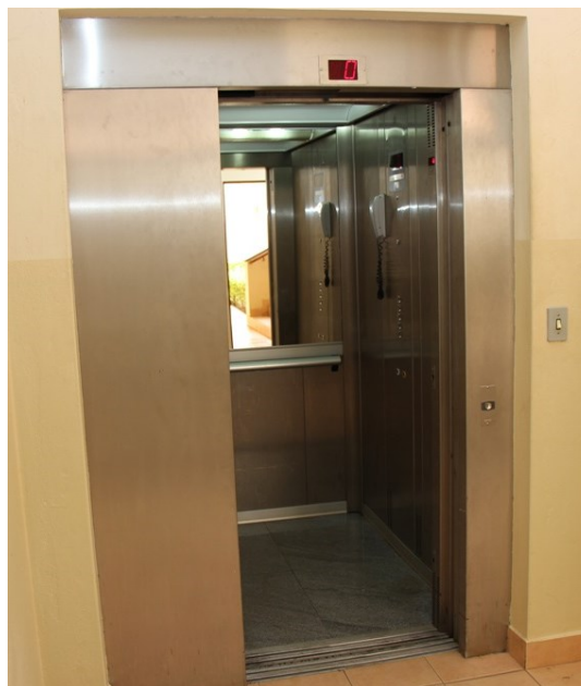
Elevadores de acesso aos pisos superiores
