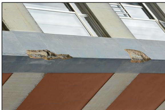
Figura 1 – Viga do edifício imperador, na cidade de Balneário Camboriú. Fonte: Diarinho, 2015.
