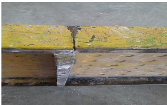
Figura 2 - Plataforma em situação inadequada: peça com fissura central. Fonte: autores.
