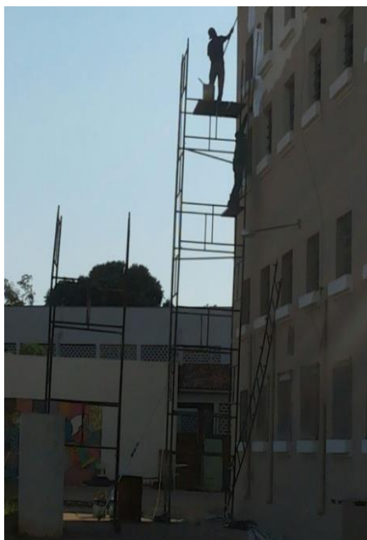
Figura 5 - Andaimes irregulares Fonte: autores.
